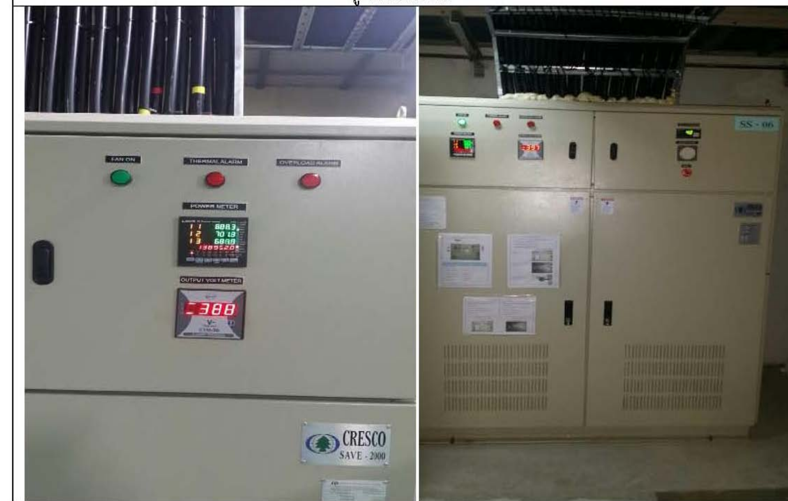
อุปกรณ์ปรับระดับแรงดันไฟฟ้าขนาด 2,000 kVA
