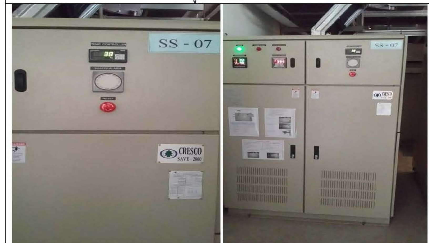
อุปกรณ์ปรับระดับแรงดันไฟฟ้าขนาด 1,250 kVA
