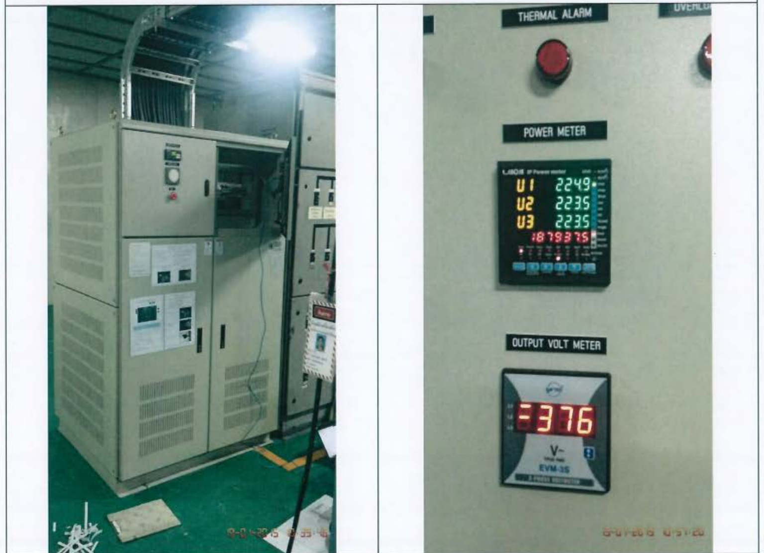
อุปกรณ์ปรับระดับแรงดันไฟฟ้าขนาด 1000 kVA
