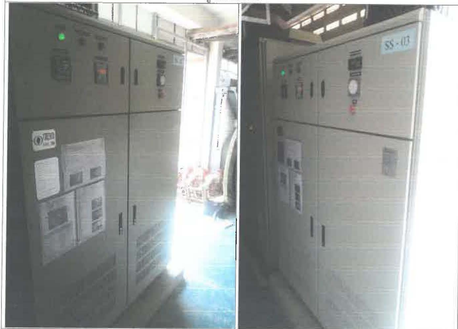
อุปกรณ์ปรับระดับแรงดันไฟฟ้าขนาด 2,000 kVA
