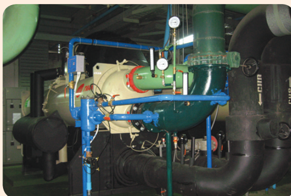
รูปที่ 8 เครื่องทำน้ำเย็นประสิทธิภาพสูงและเครื่องกำจัดตะกอน
