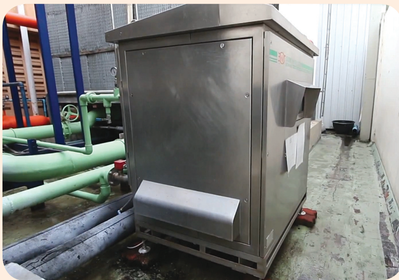
รูปที่ 7 ระบบ Ozone Generator
