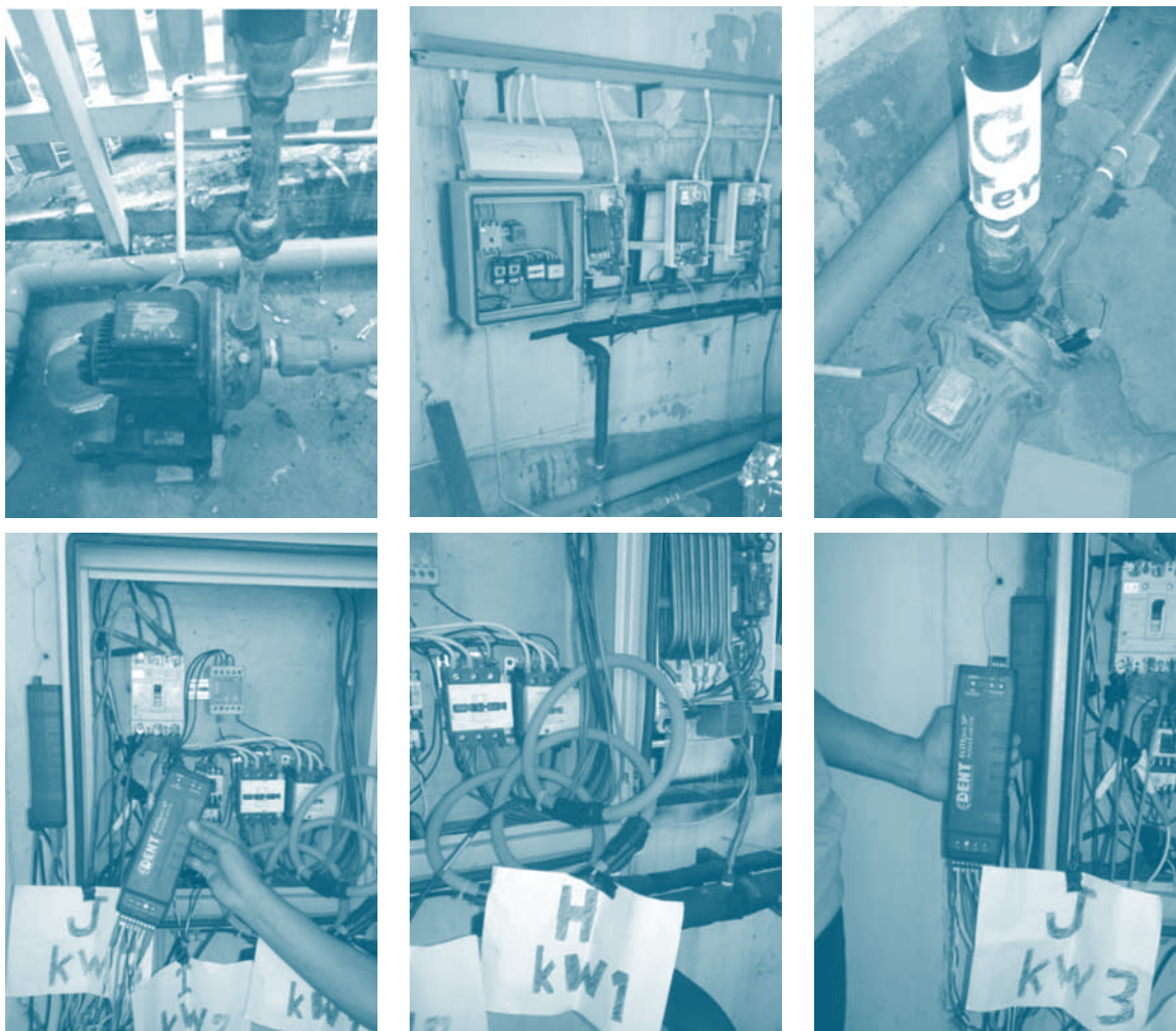
การตรวจวัดกำลังไฟฟ้าของระบบผลิตน้ำร้อนอาคาร B ก่อนการปรับปรุง
