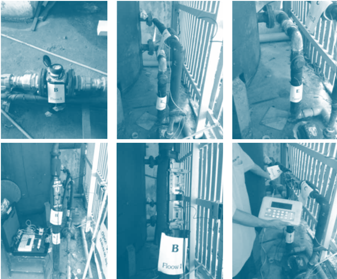
การตรวจวัดอุณหภูมิและอัตราการไหลของน้ำร้อนอาคาร B ก่อนการปรับปรุง
